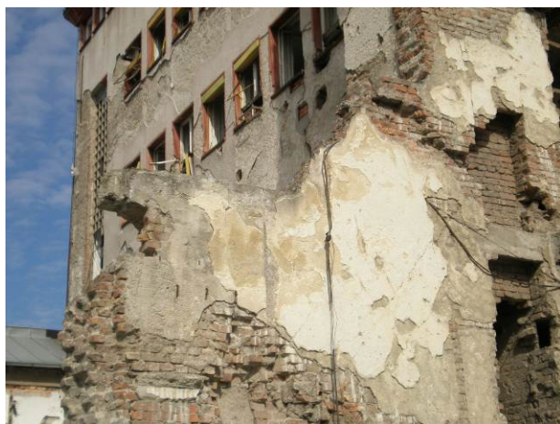
Сл.3 - Остатак зида срушеног степеништа који треба конзервирати
